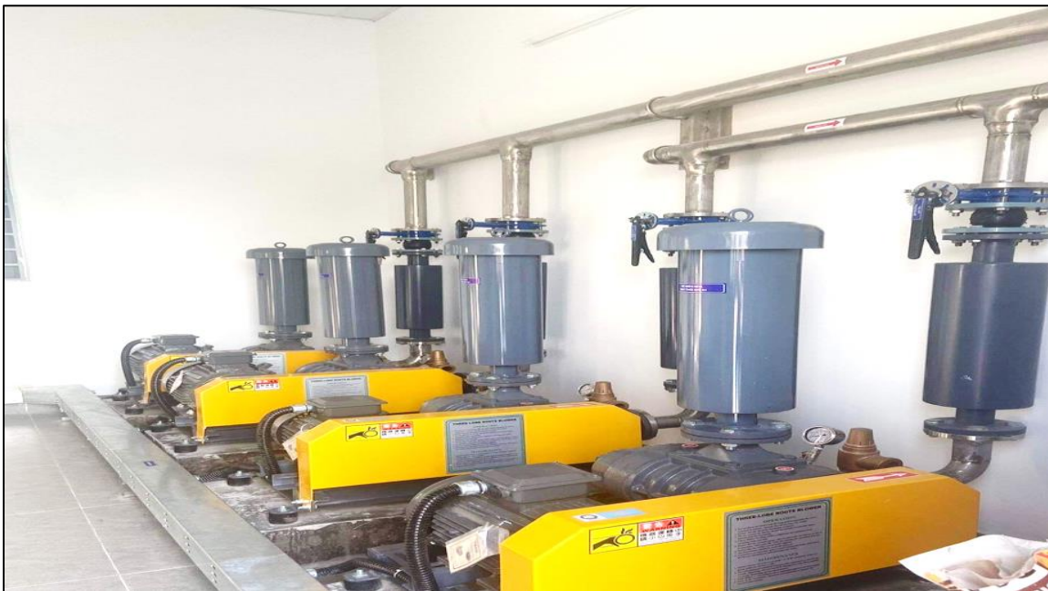
Hình 16. Hình ảnh máy móc thiết bị được lắp đặt cách âm và chống ồn trong nhà điều hành
